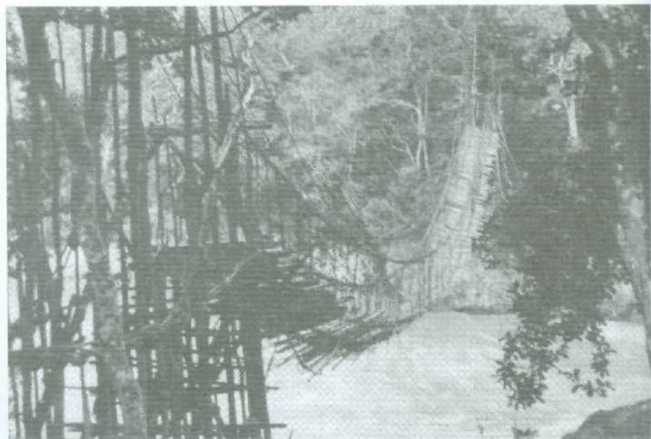
Jembatan gantung yang rusak di dekat Minimo di atas Sungai Baliem (foto: Pim Schoorl).
